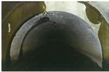
関川右岸幹線用水路トンネル部 ひび割れからの漏水
