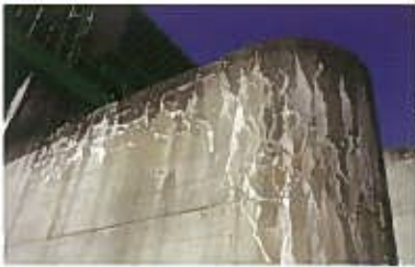
コンクリートのひび割れ
