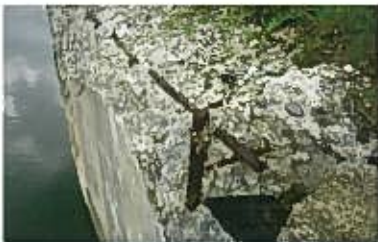
コンクリートの凍結による劣化
