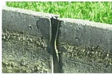
中江幹線用水路開水路部 目地部の欠損
