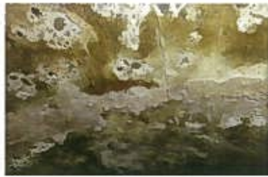
上江幹線用水路トンネル部 コンクリートの劣化
