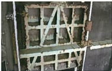
取水ゲート腐食による劣化
