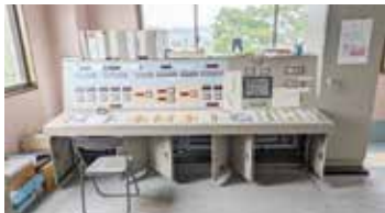
十ケ字頭首工 R8年度工場製作を実施する水管理制御設備
