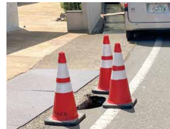
農業用水路脇の市道が陥没
